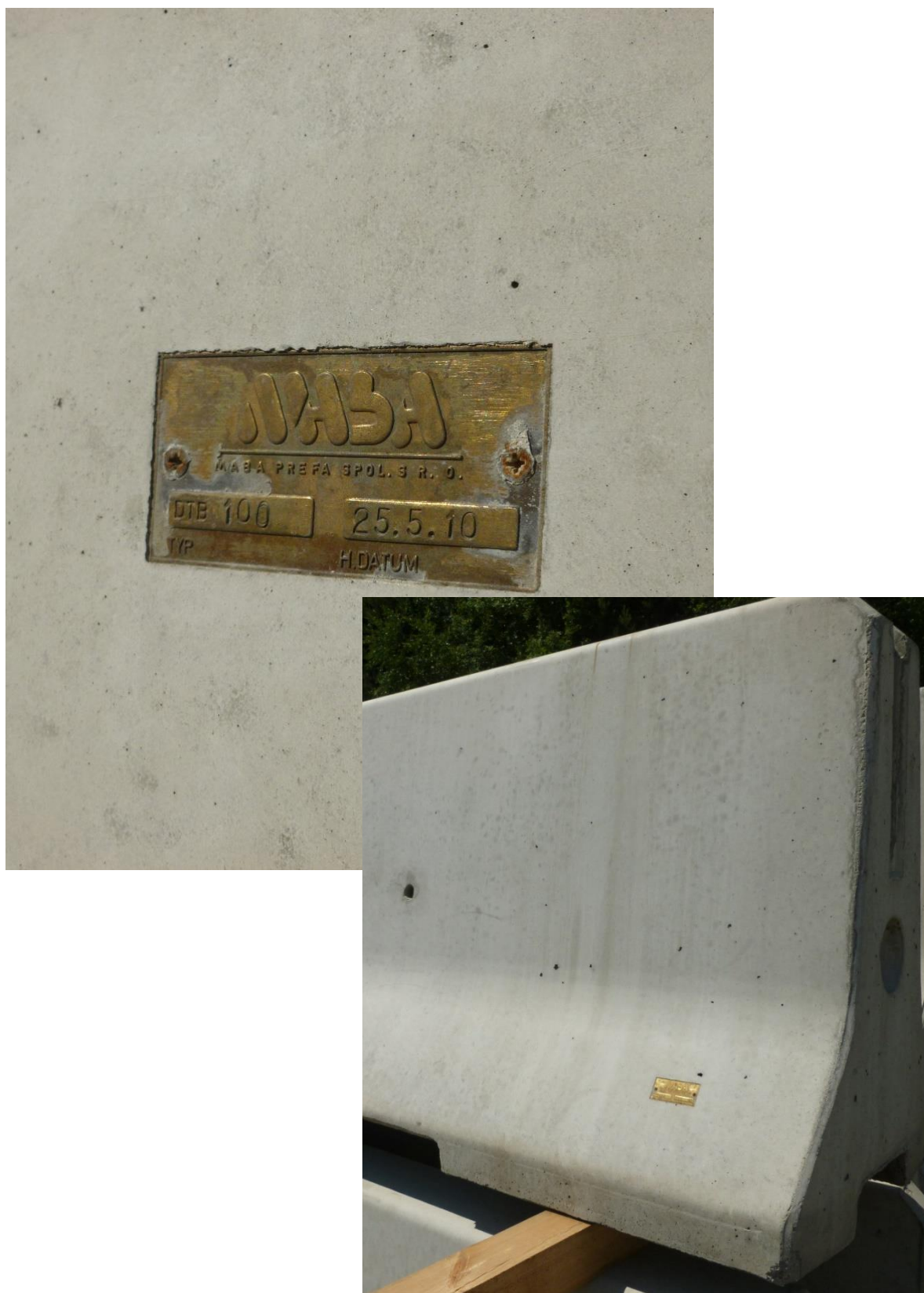
Obrázek 51 – Trvanlivé značení kovovým štítkem
