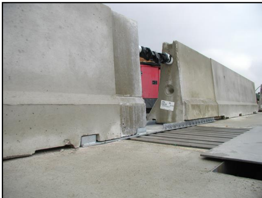
Obrázek 47 – Pohled na vodící plech u dilatace 900 mm z rubu svodidla
